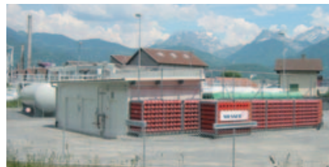
Verdichterstation für Wasserstoff mit Speicheranlage in Monthey.
