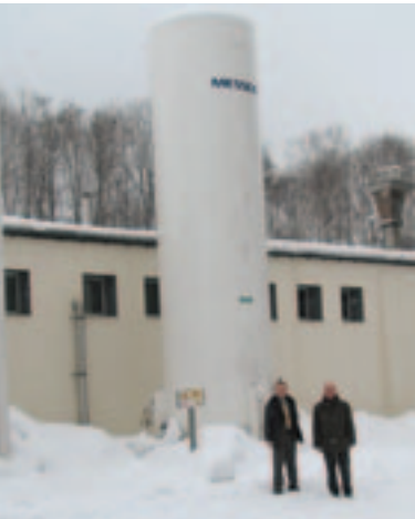
Firma FVZ DeliMeat in Orzesze frostet ihre Fertigspeisen im Cryotunnel mit flüssigem Stickstoff von Messer Polska.
