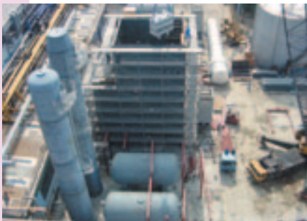
Messer baute in Smederevo eine neue Luftzerlegungsanlage, die Anfang 2006 ihren Betrieb aufgenommen hat.
