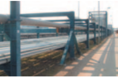
Messer Carburos betreibt ein Rohrleitungssystem zur Versorgung seiner Industriekunden.
