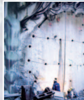
Für die Erweiterung des Wiener U-Bahn-Netzes wurde mit Stickstoff von Messer das Erdreich gefroren, um Erdreichrutschungen zu vermeiden (siehe auch Seite 26).
